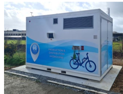
Station de Production, de stockage et de distribution d'hydrogène
